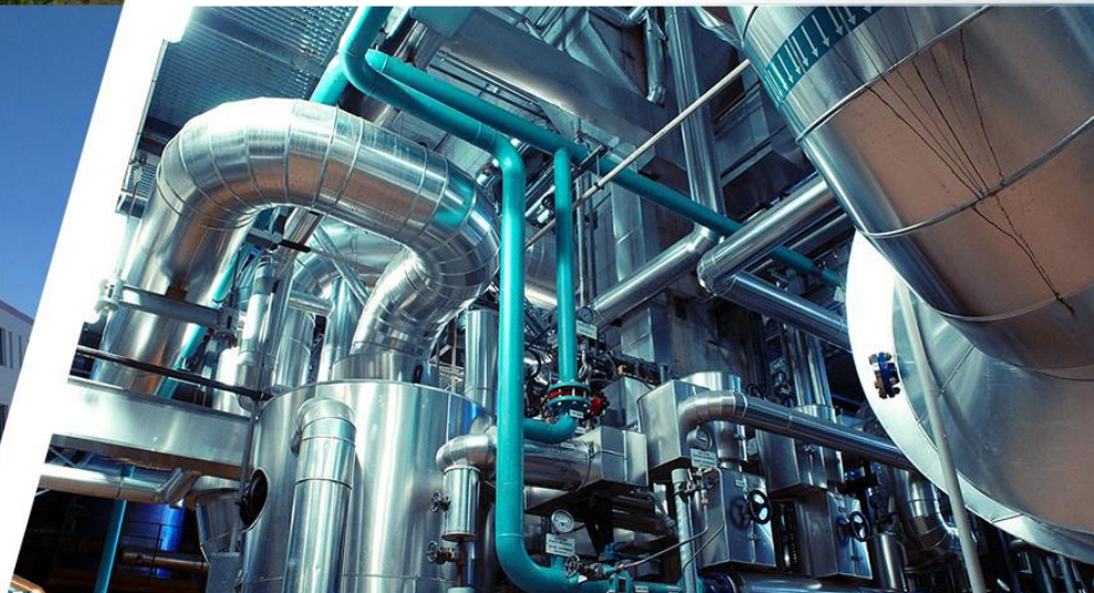
AUTOMATYKA I ELEKTROTECHNIKA
